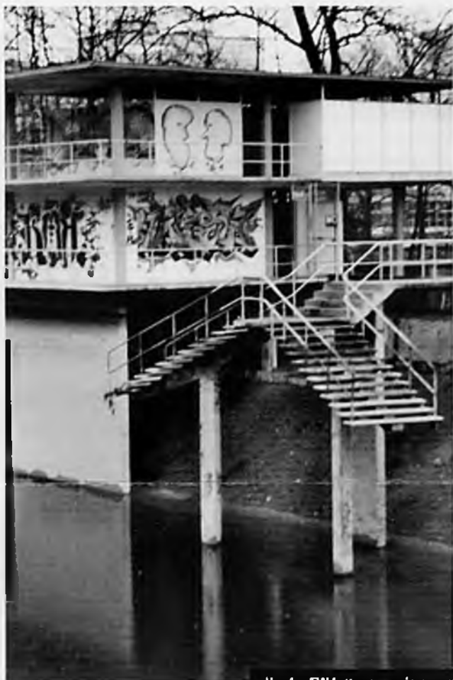
Um das EW Letten zu sanieren, wurde die Limmat um ein paar Meter abgesenkt (beim Oberen Letten).
