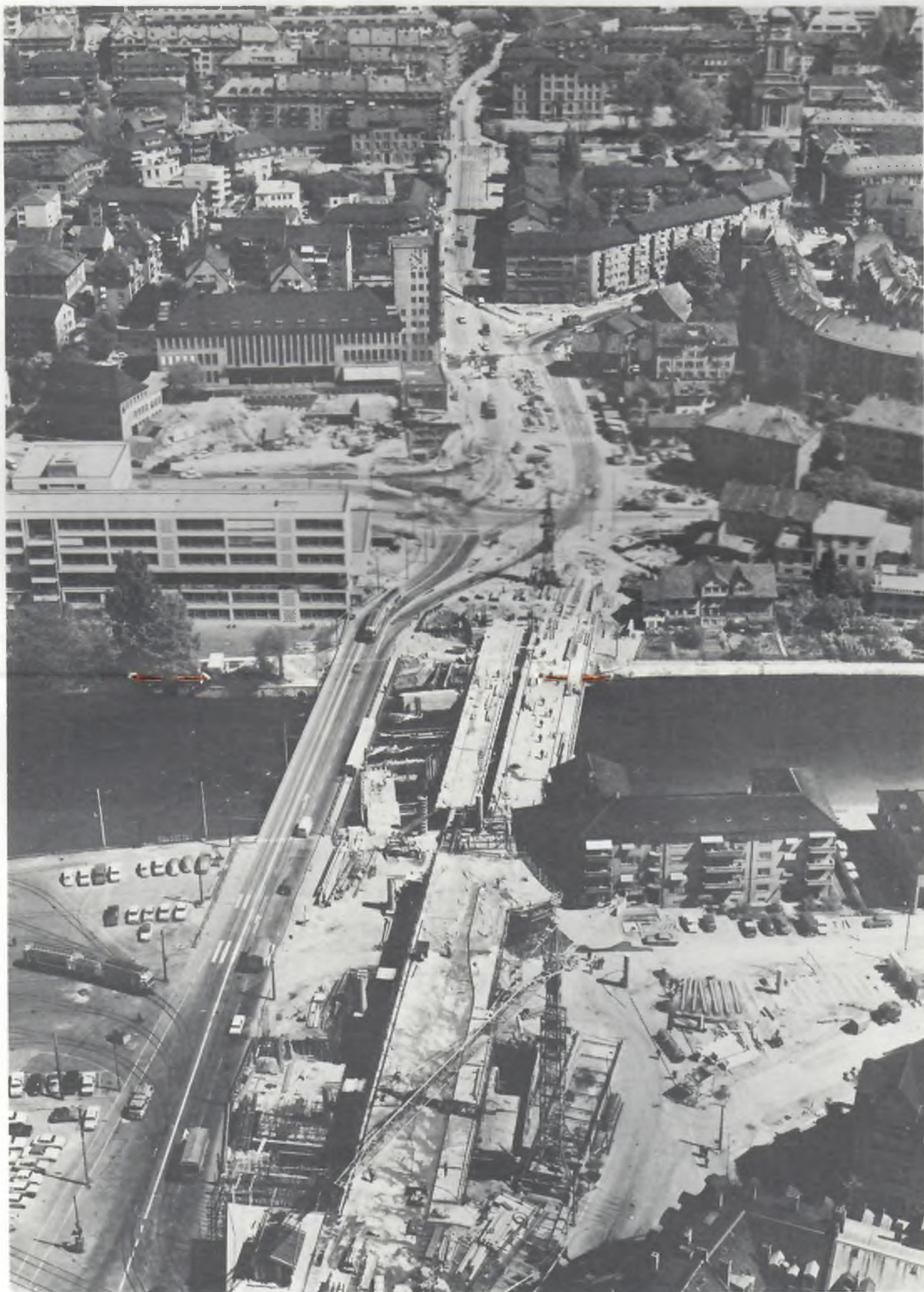
Wipkingenbrücke im Bau, Mai 1969, die 3. untere Brücke noch nicht erstellt; der ganze Verkehr aufwärts über die Hilfsbrücke nebenan, seit Mitte Oktober ausser dem Tram über die 1. neue Brücke; von der Hochbrücke fehlte Ende des Jahres nur noch ein Zwischenstück beim Wipkingerplatz. (Comet-Flugaufnahme)
